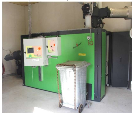
Heizomat AK, 200 kW Leistung
